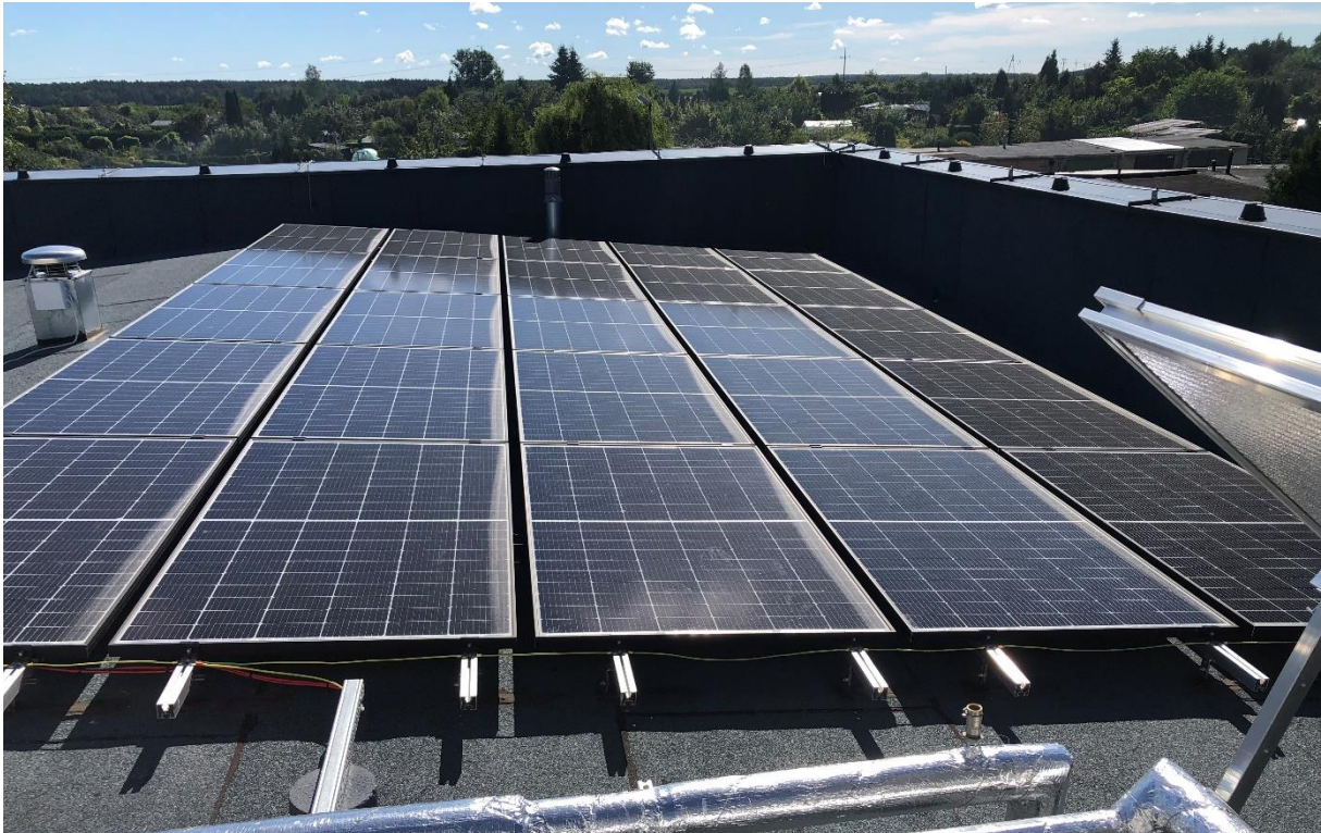
Instalacja fotowoltaiczna w Gminie Ujazd
