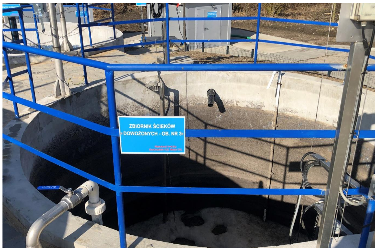
Zbiornik ścieków dowożonych w oczyszczalni ścieków w Domaniewicach
